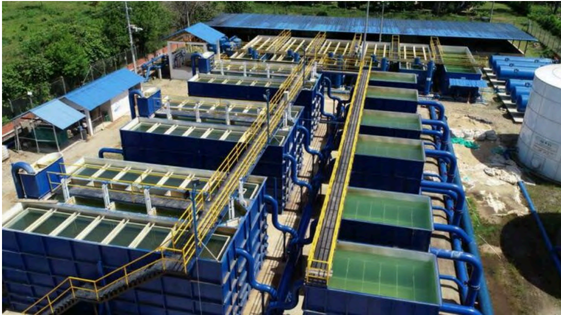
Intervienen Empresa de Acueducto, Alcantarillado y Aseo de Yopal por crítica situación
