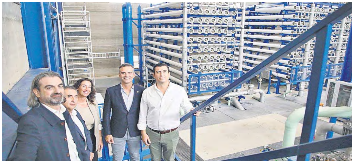
Consejero, alcaldes de Almería y Níjar, así como directivos de Aqualia, en el interior de la planta desaladora, donde se observa maquinaria de última generación.
