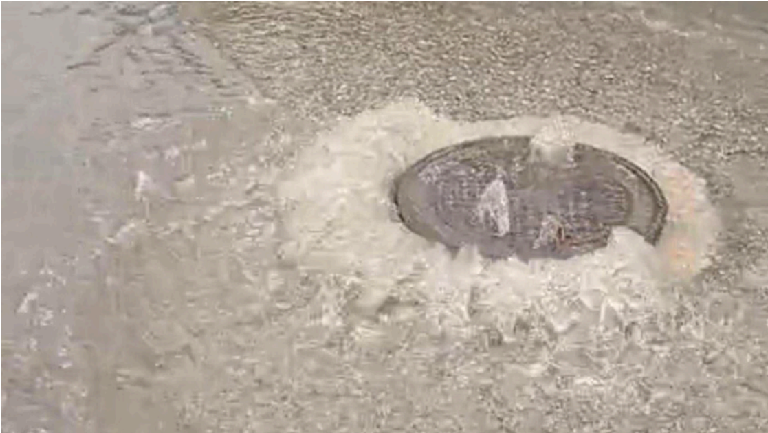
Alcantarilla desbordada en Yeles (Toledo).
