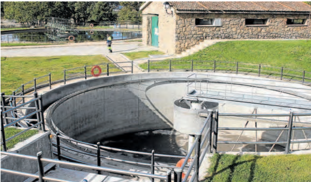
Depuradora del Real Sitio de San Ildefonso. EL NORTE
